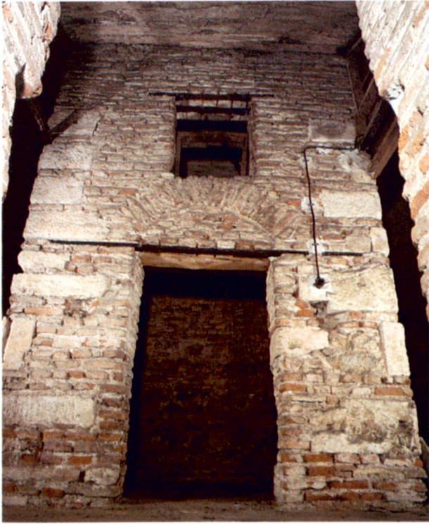
Camlı Köşk'ün havuzunu desteklemek üzere altındaki eski yapının ortasına D'aronco'nun 26 Ekim 1897 tarihli mektubunda inşa edilmiş olduğunu belirttiği duvar.
